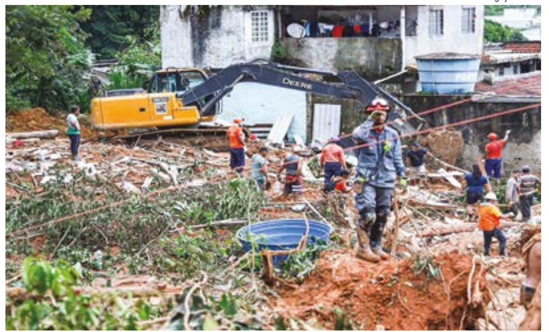
Estragos das fortes chuvas que atingiram São Sebastião; região recebe projeto-piloto do Governo do Estado
