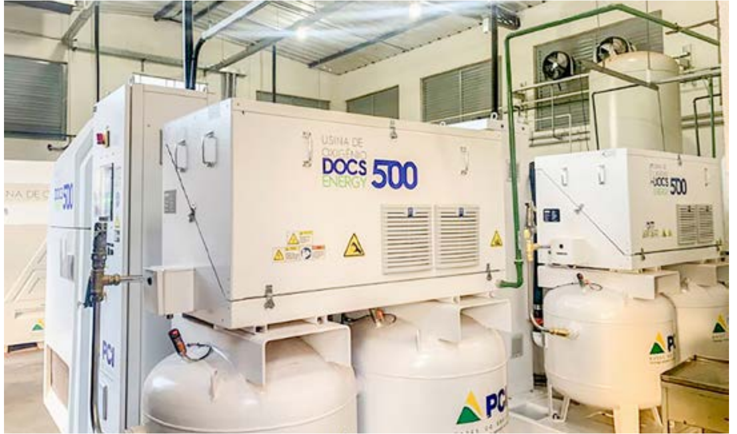
Estrutura adquirida pela Santa Casa de Cruzeiro, que espera por maior economia e agilidade no atendimento a pacientes do município
