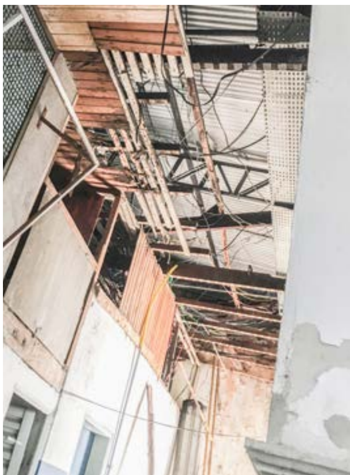
Telhado do espaço tem flagrantes de infiltrações e invasão de passaros
