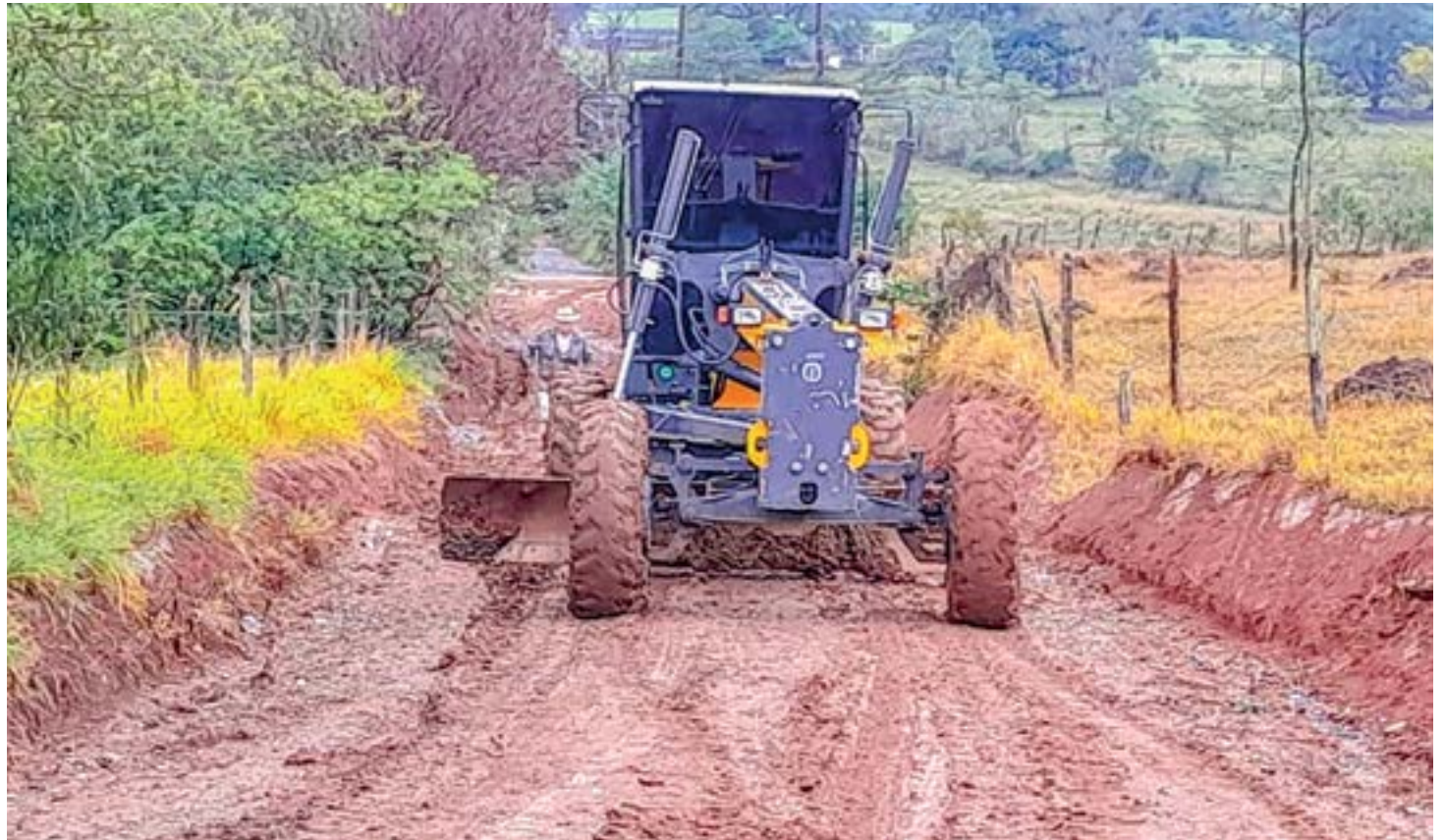
Trabalho de recuperação de estrada na zona rural; trabalho da Prefeitura é intensificado para garantir mobilidade para famílias do Goiabal
