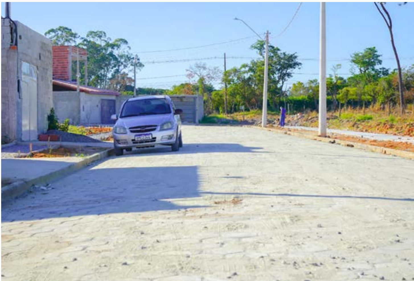
Rua da Vila Rica, com obra finalizada com recursos federais; moradores enfrentavam transtornos por causa das vias que eram de terra
