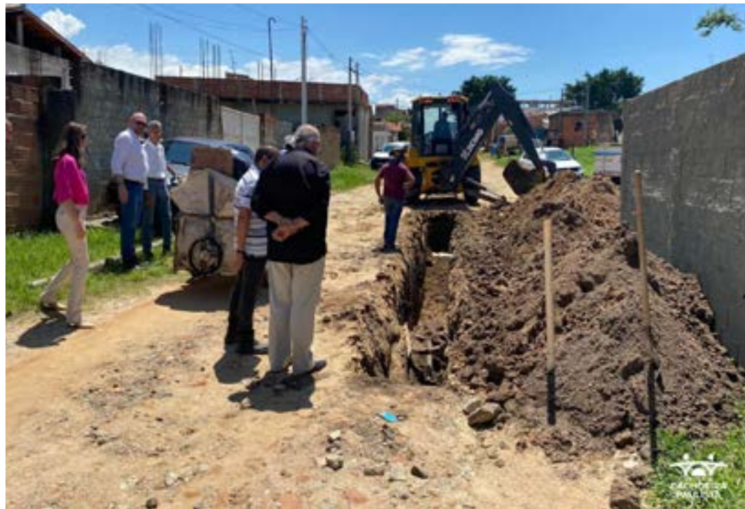
O prefeito Antônio Carlos Mineiro acompanha obra da Sabesp para saneamento no Nova Esperança
