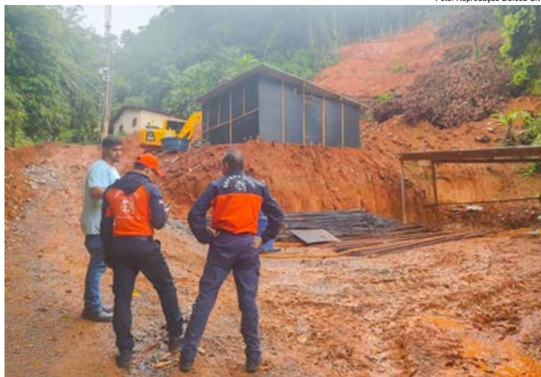
Trabalho da equipe da Defesa Civil após as fortes chuvas que afetaram Ubatuba no início da última semana
