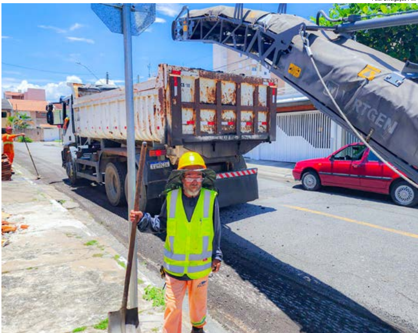
Funcionário da Prefeitura de Pindamonhangaba que atua em obra de pavimentação no Parque São Domingos; previsão de R$ 500 mil investidos
