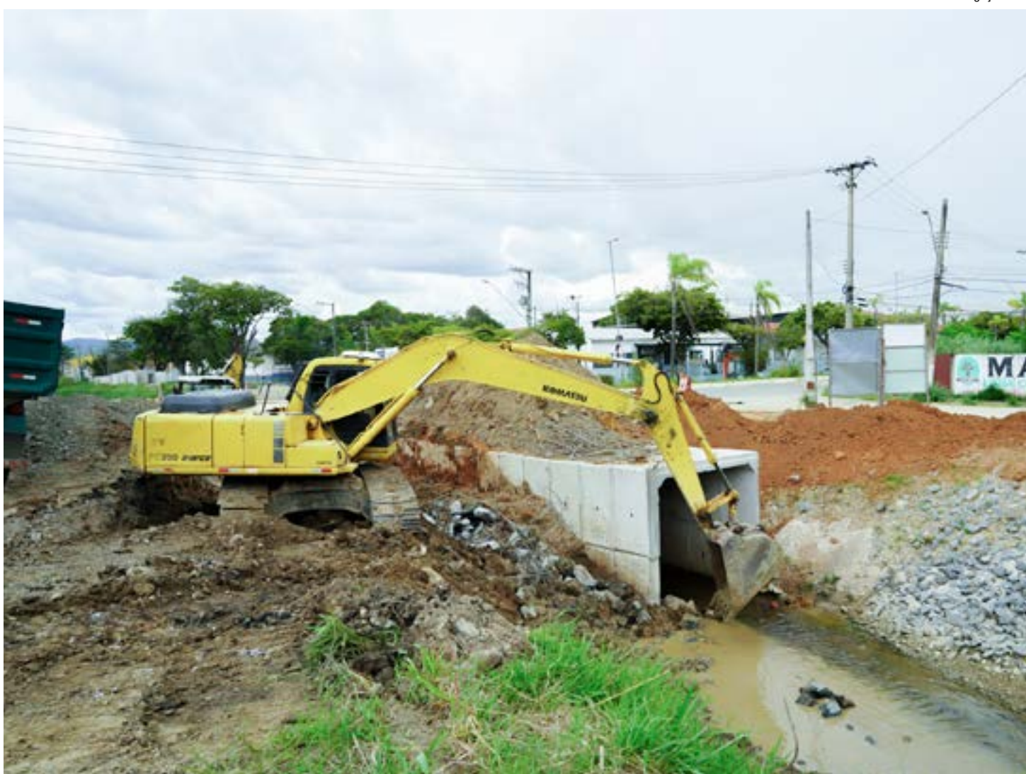
Trabalho de implantação de aduelas para drenagem; obra nas ruas da Vila Nunes contam com investimento de R$ 1,6 milhão do Município
