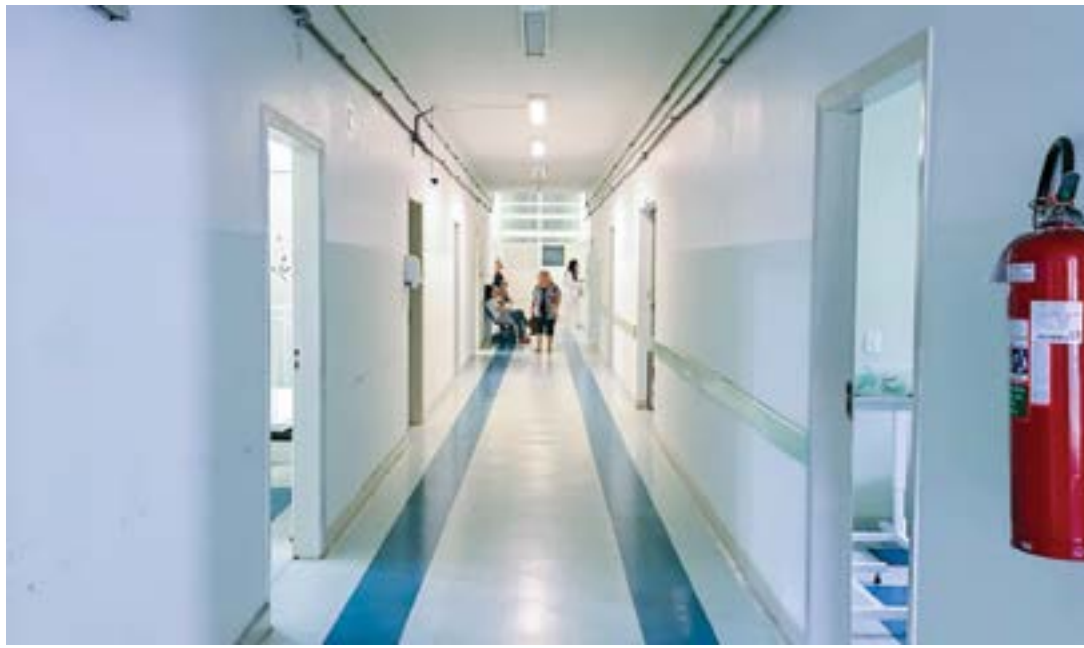
Corredor da Santa Casa de Cachoeira, em reconstrução após o fim de intervenção; novo parto em dois meses
