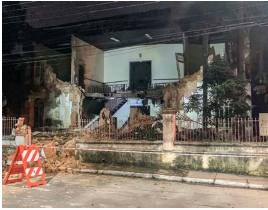
Flagrante de desmoronamento de fachada da antiga sede da Prefeitura de Guaratinguetá, no último dia 6
