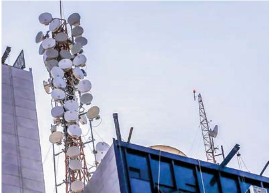
Antena de conexão celular para telefonia; cidades da RMVale tentam se adequar à nova tecnologia
