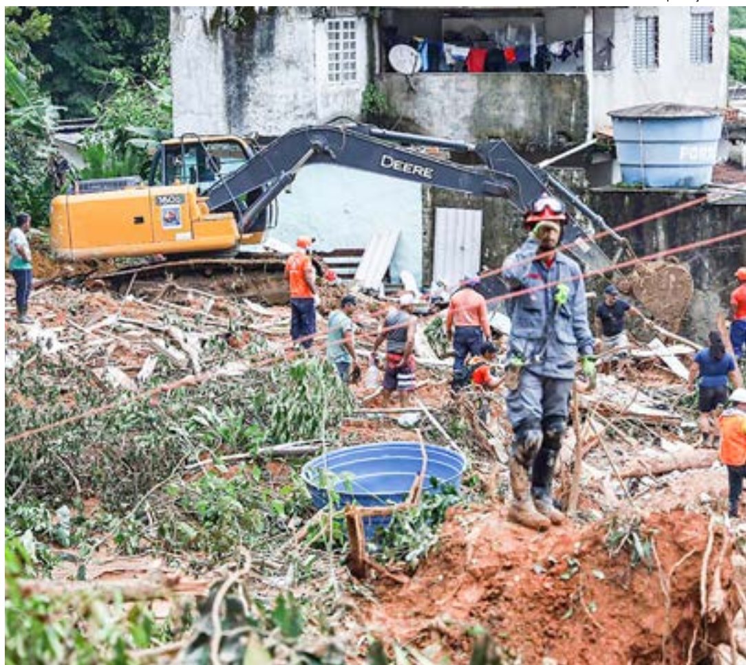
Trabalho em áreas de desmoronamento em São Sebastião; Governo do Estado quer prevenções contra
