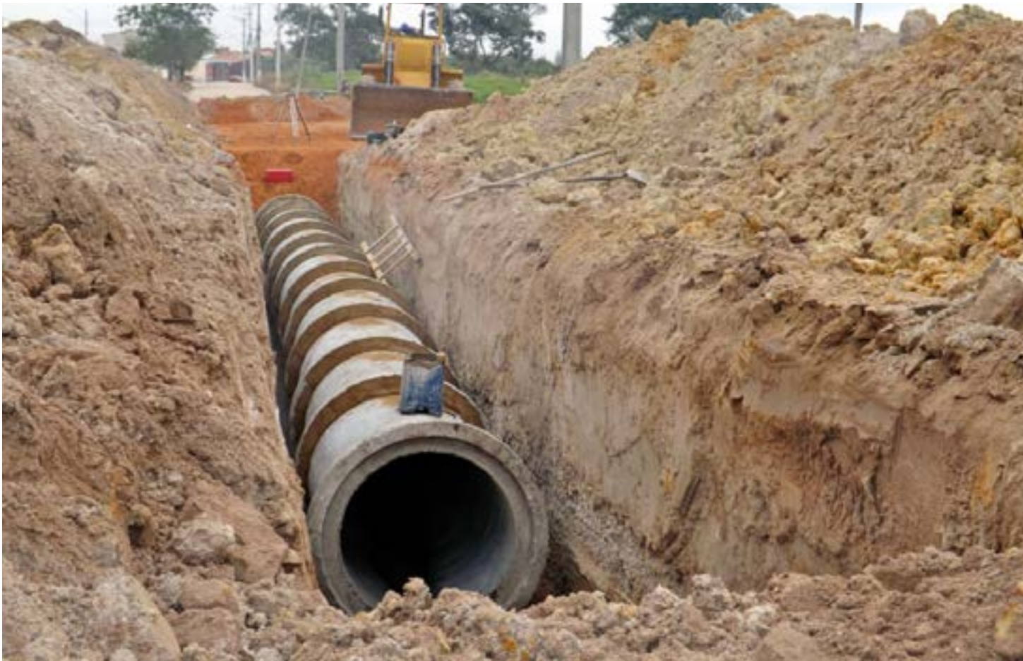
Obra de macrodrenagem em Lorena; Ministério Público consegue aval da Justiça em nova denúncia sobre contrato da Prefeitura para Plano Diretor
