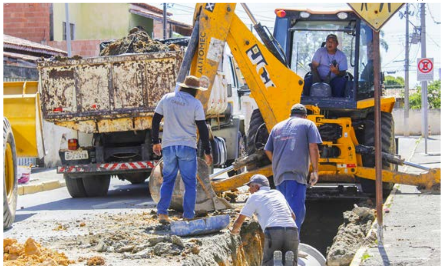
Serviços de implantação de manilhas para escoamento de águas pluviais; Canas investe em drenagem para prevenção ao período de chuvas
