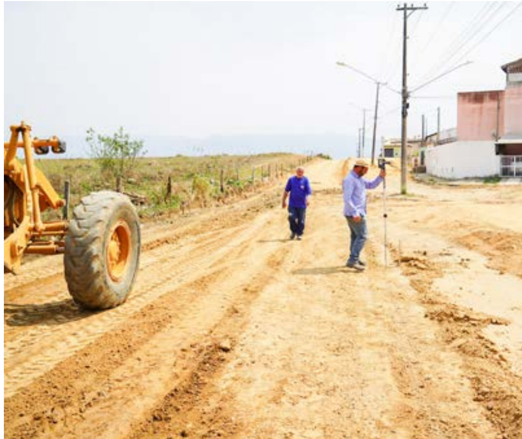
Obras na Avenida Brasil, em Lorena; cidades da RMVale recebem investimentos federais para infraestrutura
