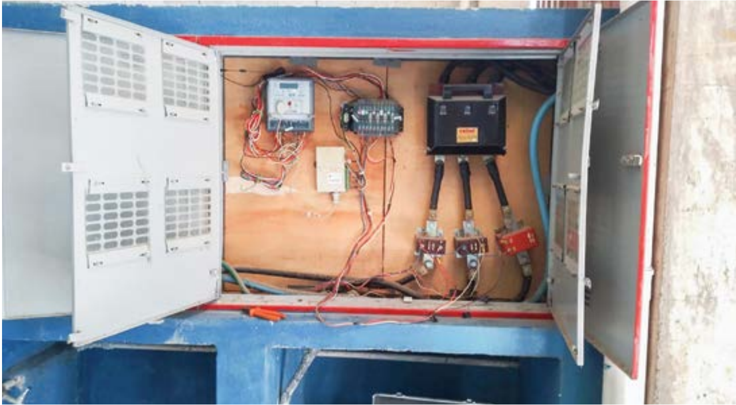
Flagrante de instalações irregulares em um dos dois hotéis citados; fraudes são constatadas em medidores de energia na rede hoteleira da cidade
