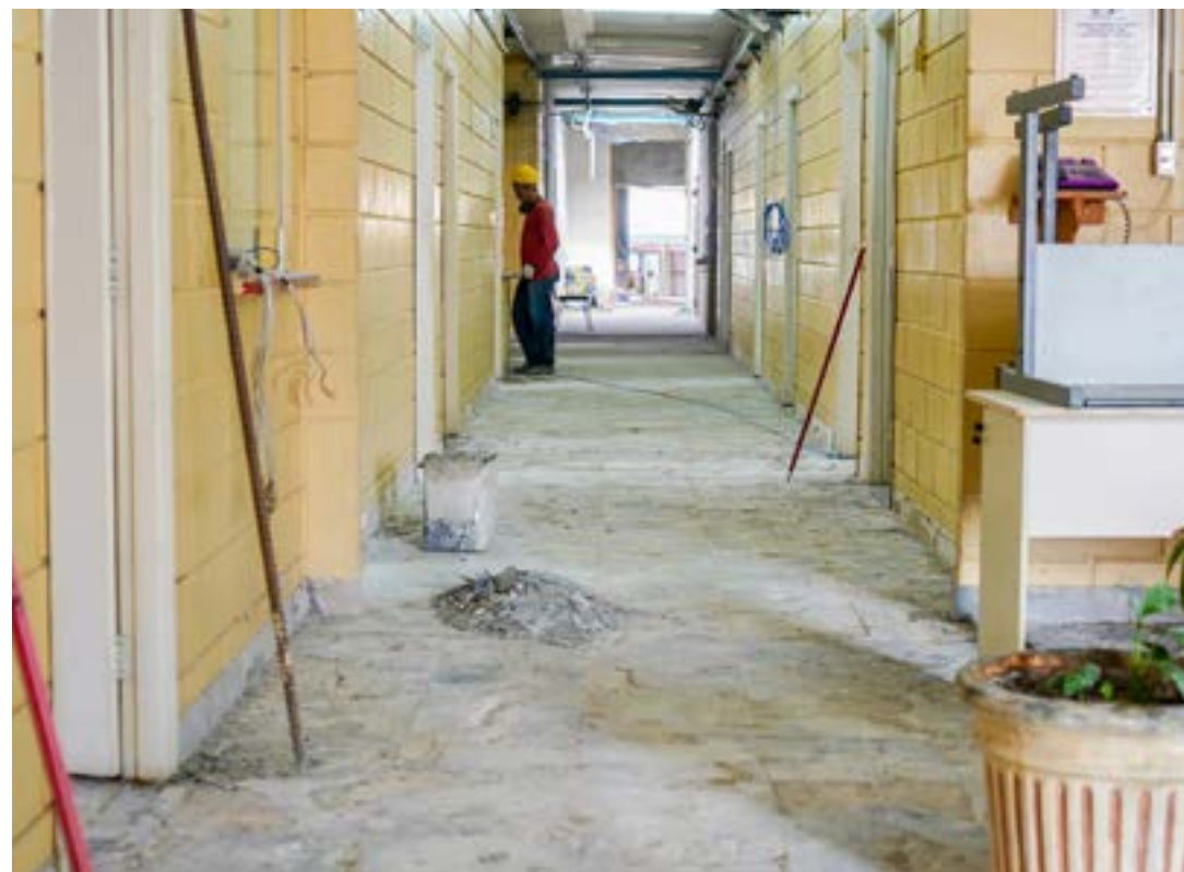
Obra em Unidade Básica de Saúde de Lorena; cidade mantém alto investimento para qualificar serviços
