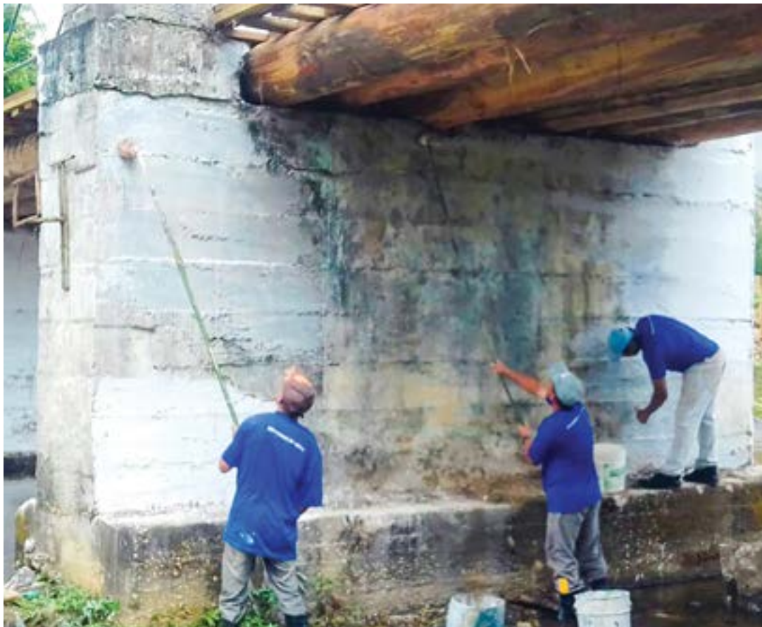
Obra de 2017, que focou estrutura da ponte do Taquaral, será repetida com verba de R$ 1 milhão neste ano
