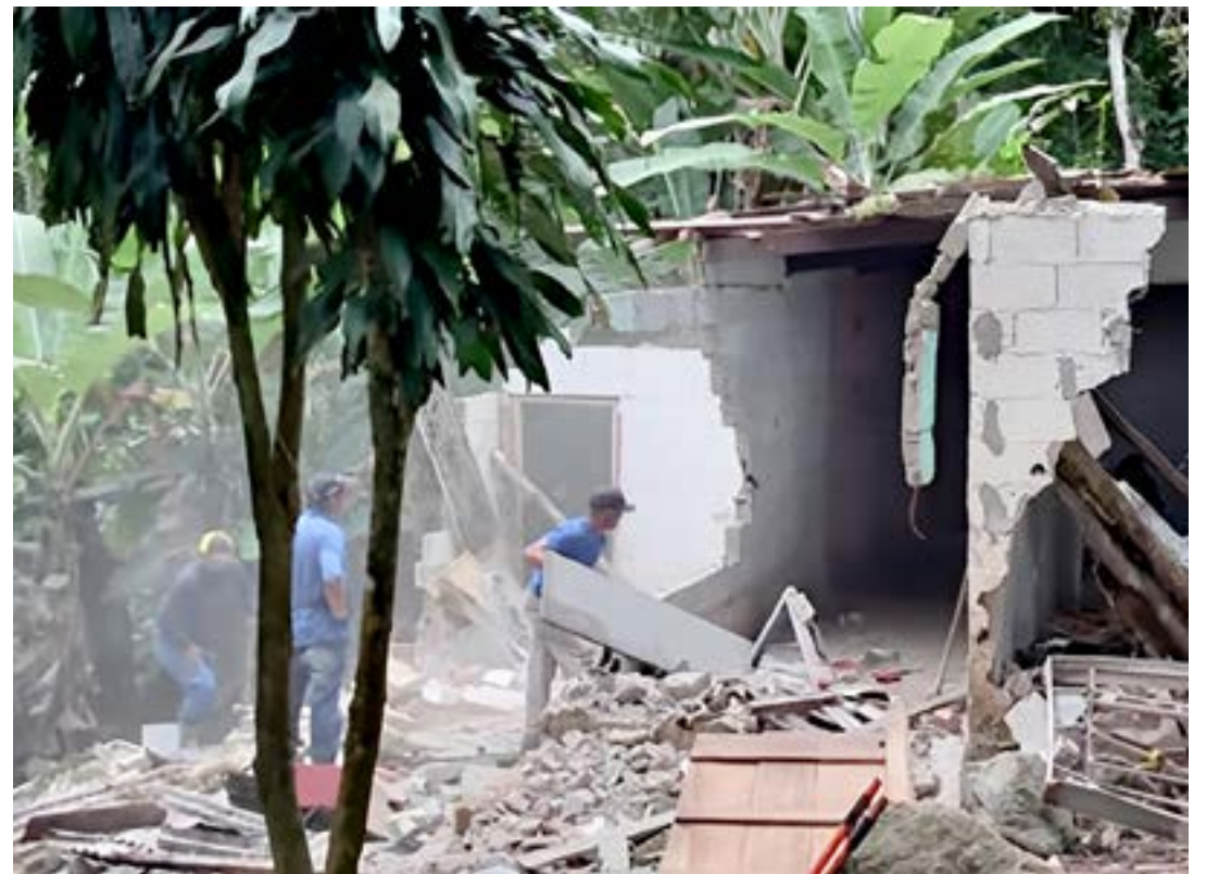
Trabalho de demolição de construção irregular em Caraguatatuba; cidade aumenta fiscalização sobre obras
