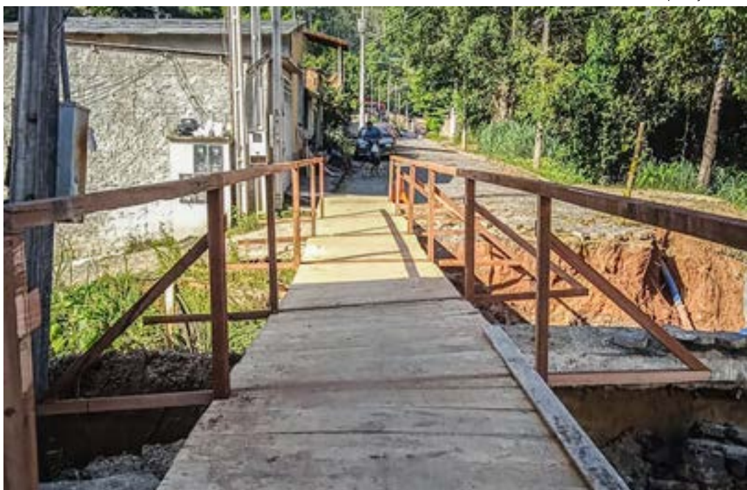
Ponto provisório de passagem implantado no acesso ao Turma 26, após queda da ponte, em Cachoeira
