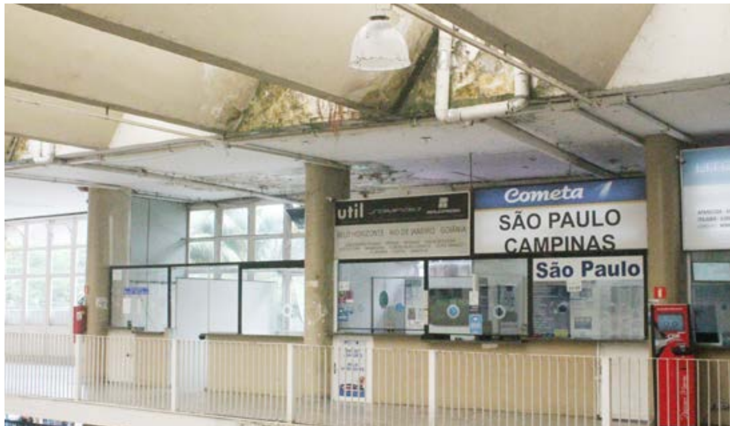
área de guichê para compra de passagens na rodoviária de Guaratinguetá próximo às infiltrações no telhado; críticas continuam na Câmara
