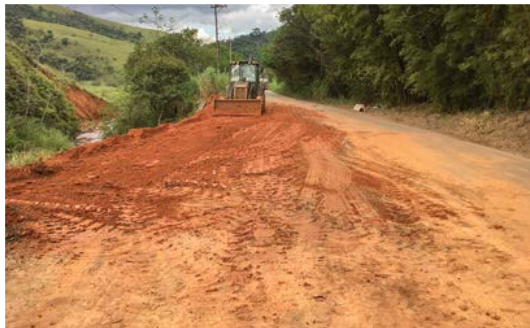
Estrada em Cruzzeiro que deve passar por recuperação; trabalho de pavimentação atende cidades da região
