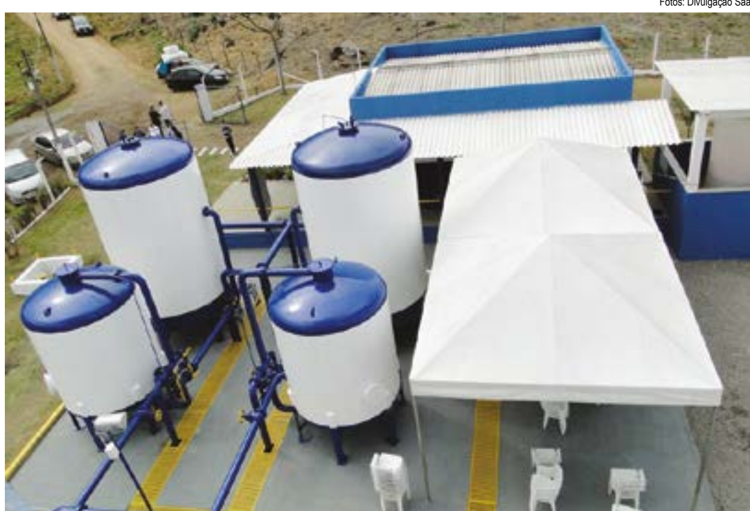
Estação de tratamento em Cruzeiro; Prefeitura anuncia investimento para nova estrutura para o esgoto
